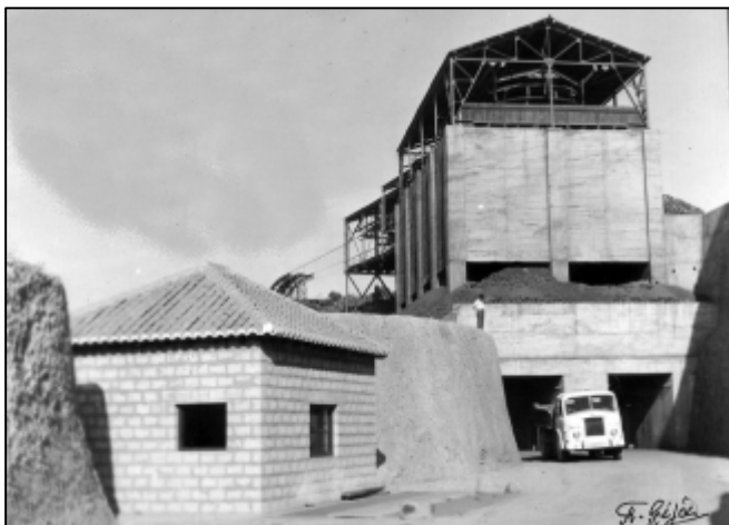
Estación de descarga del cable aéreo en Rules
